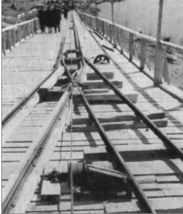
Rails utilisés pour les wagonnets faisant la navette entre la tranchée et le moulin.
